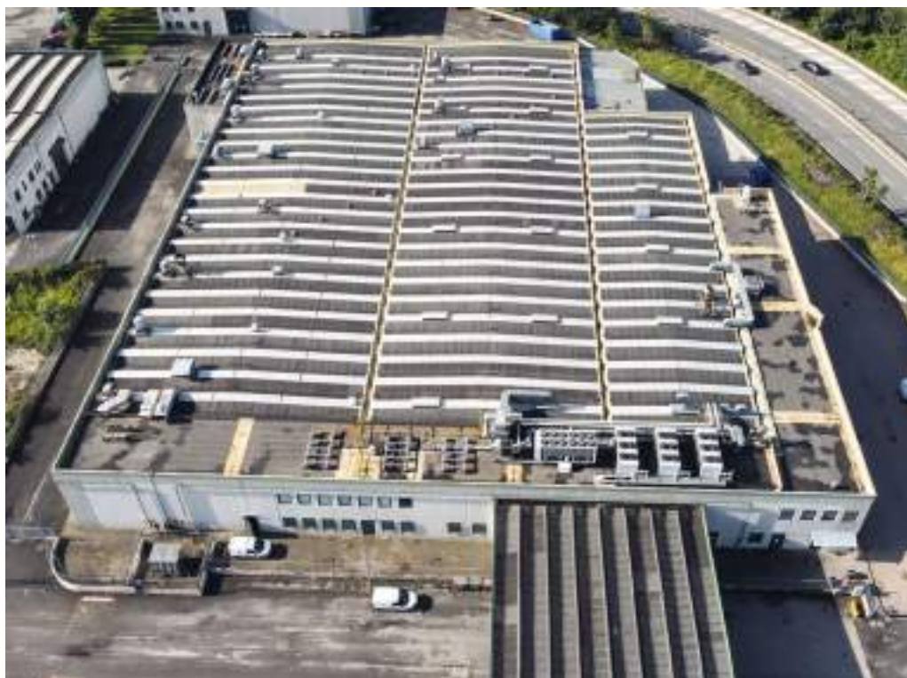
FIORI ALPINI San Mauro Torinese (TO) Prima e dopo l'intervento Rifacimento copertura mq. 5.000
